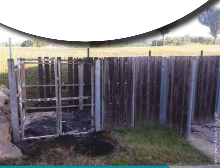
Incendie du local poubelle du Galet
