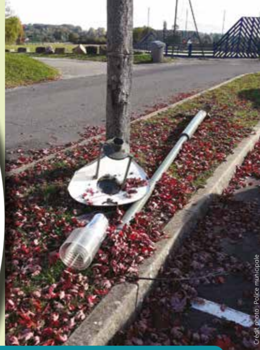
Un candélabre dégradé rue du collège
